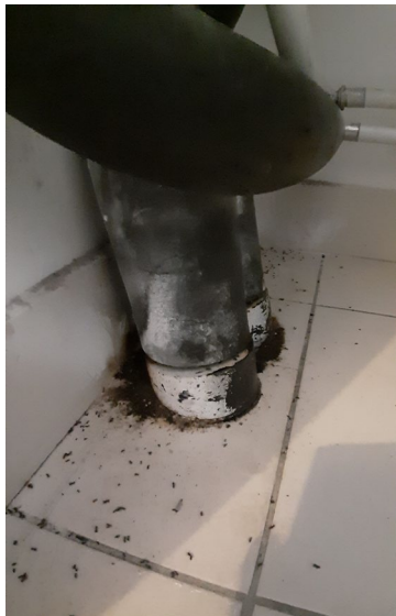
Figure 4. Dégâts provoqués par les Tapinoma le long des tuyaux d'évacuation des eaux usées dans une maison en Aquitaine. Cliché A. LENOIR.
